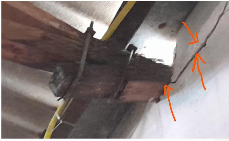
Figura 4: Rachadura na extremidade da tesoura x parede
