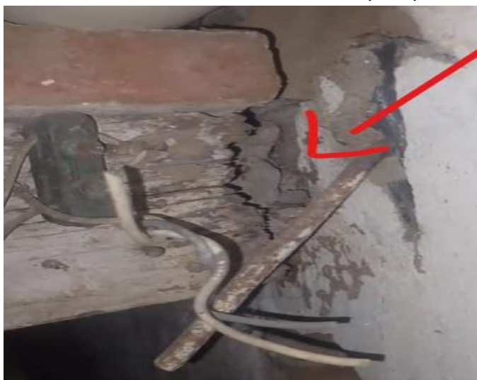
Figura 1: Extremidade da linha serrada rompida parcialmente
