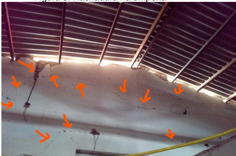
Figura 5: Rachadura na empena
